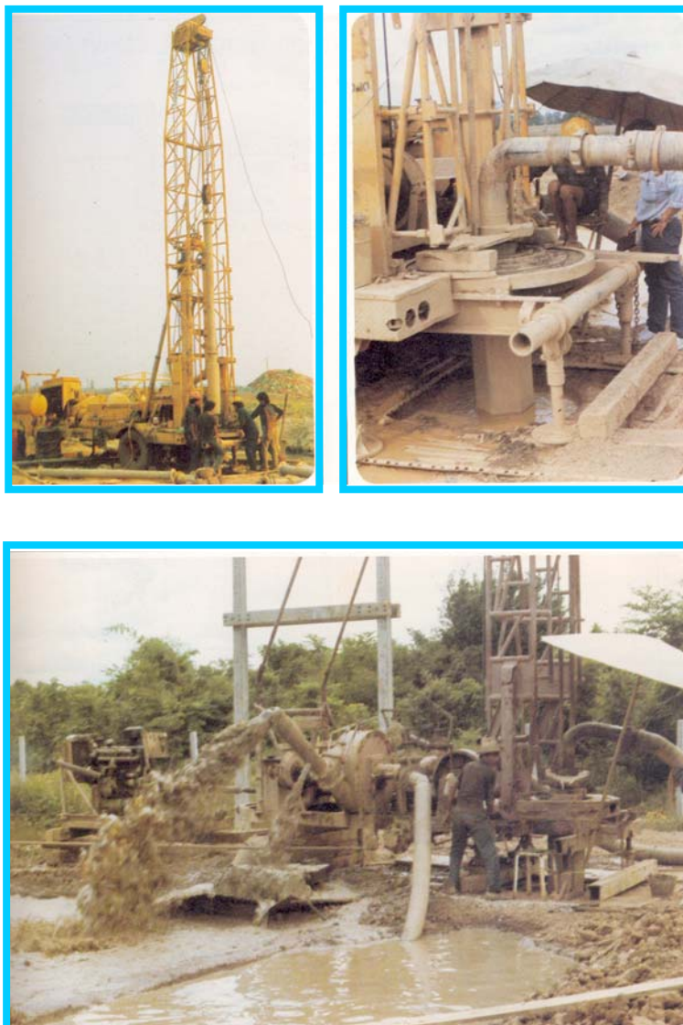
ภาพที่ 10.1 การขุดเจาะบ่อน้ำใต้ดินขนาดใหญ่
